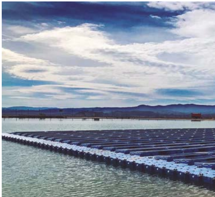
Bombeo solar flotante sobre balsa y dos bombas subterráneas para el autoconsumo de la Comunidad de Regantes de Llíria, Valencia (España)
