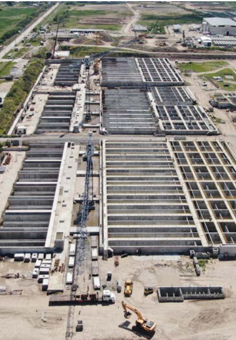
Ampliación de la Planta Potabilizadora General Belgrano, Buenos Aires (Argentina)
