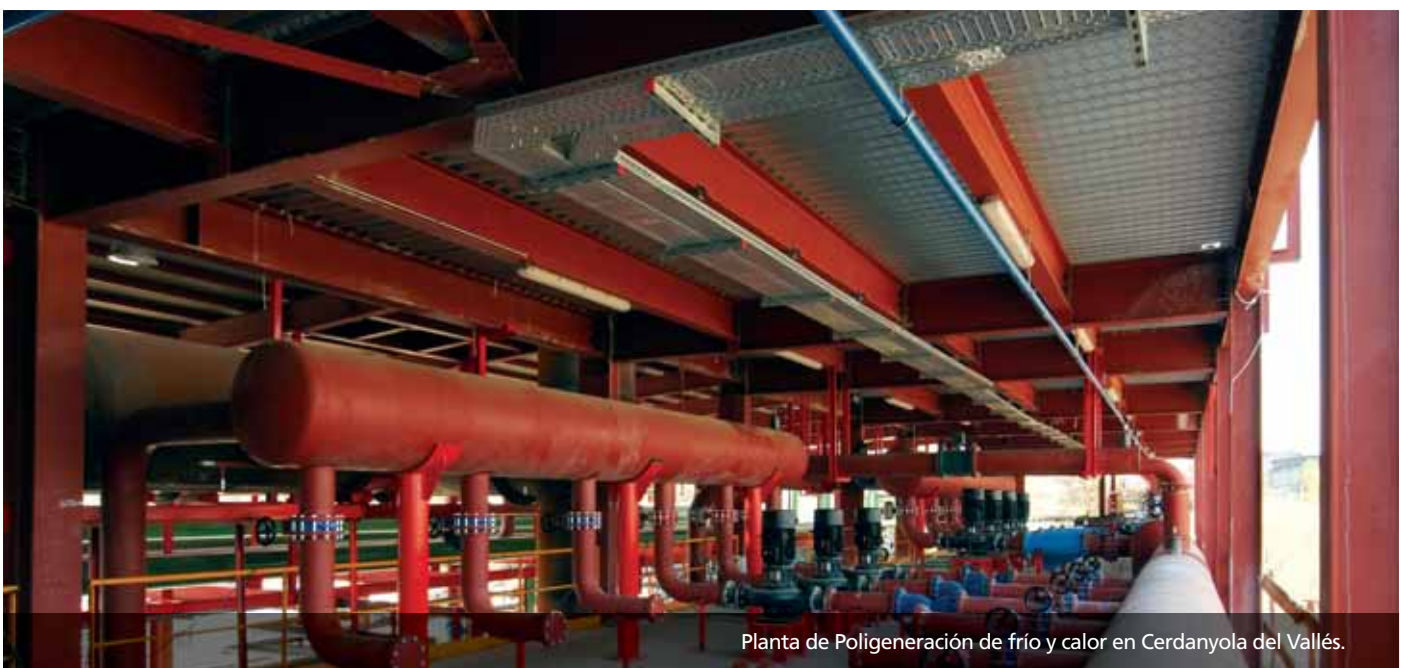
Planta de Poligeneración de frío y calor en Cerdanyola del Vallés.
