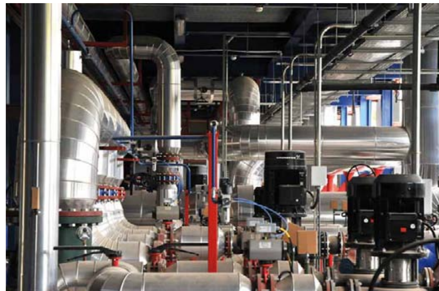
Planta de Poligeneración de frío y calor en Cerdanyola del Vallés, Barcelona
