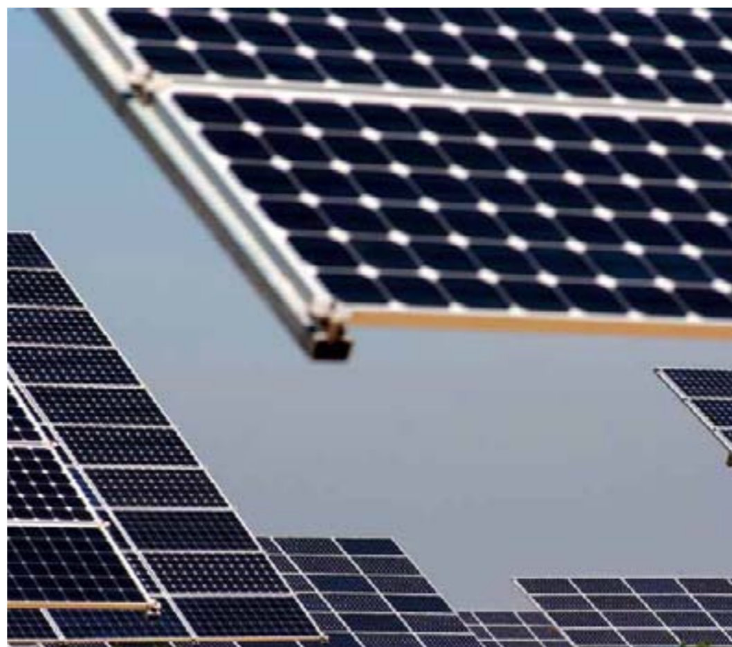
Energía solar fotovoltaica
