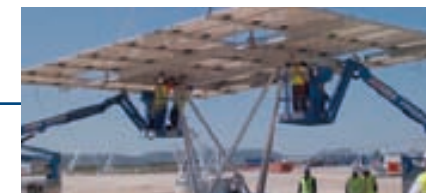
Mantenimiento de Plantas Fotovoltaicas
