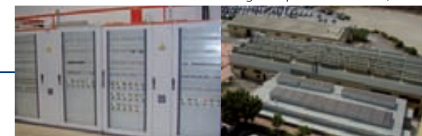
Venta de energía Hospital Torrecárdenas, Almería
