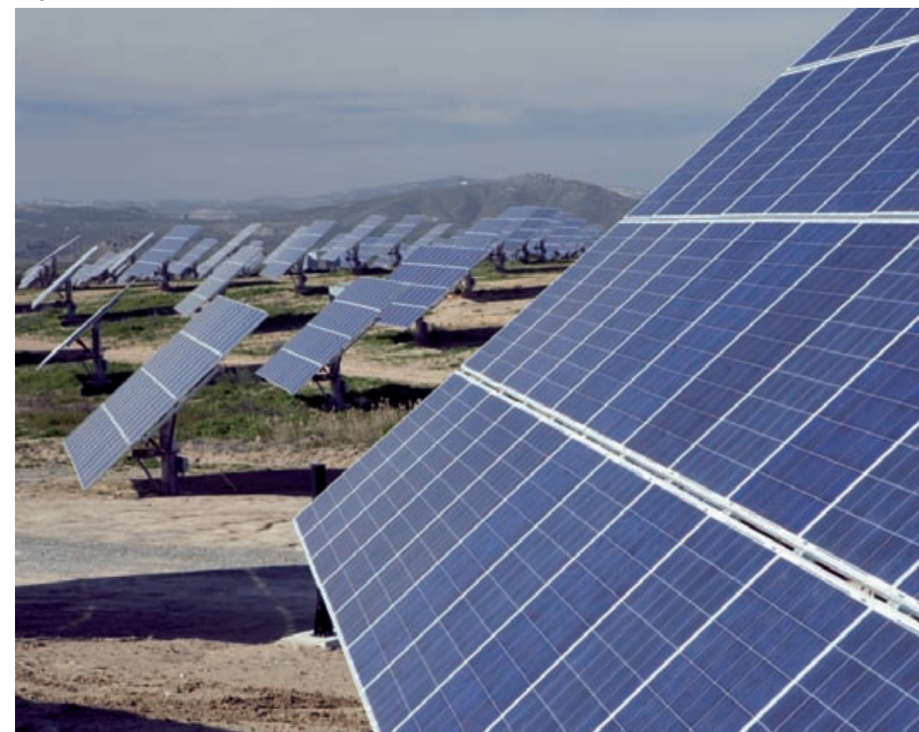
Energía solar fotovoltaica
