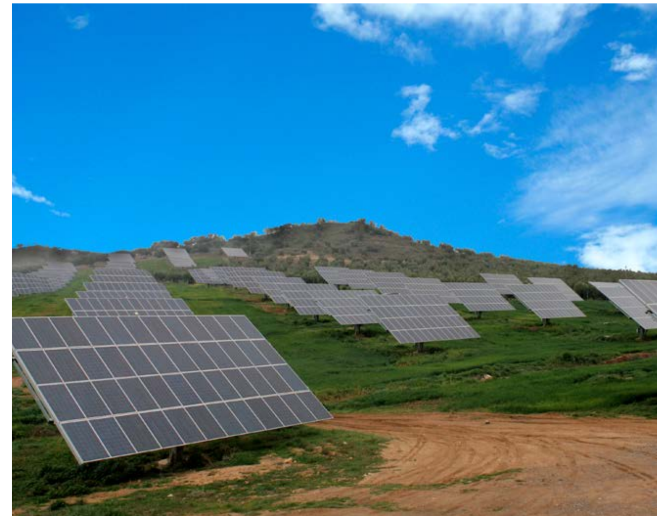
Planta fotovoltaica en Alcaudete, Jaén (5,4 MW). Ingeniería y proyecto GSJ Solutions / Ejecución SANJOSE Constructora
