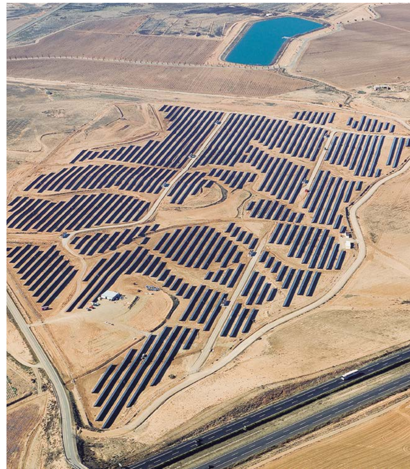
Parque solar fotovoltaico en Abilias, Navarra (España)
