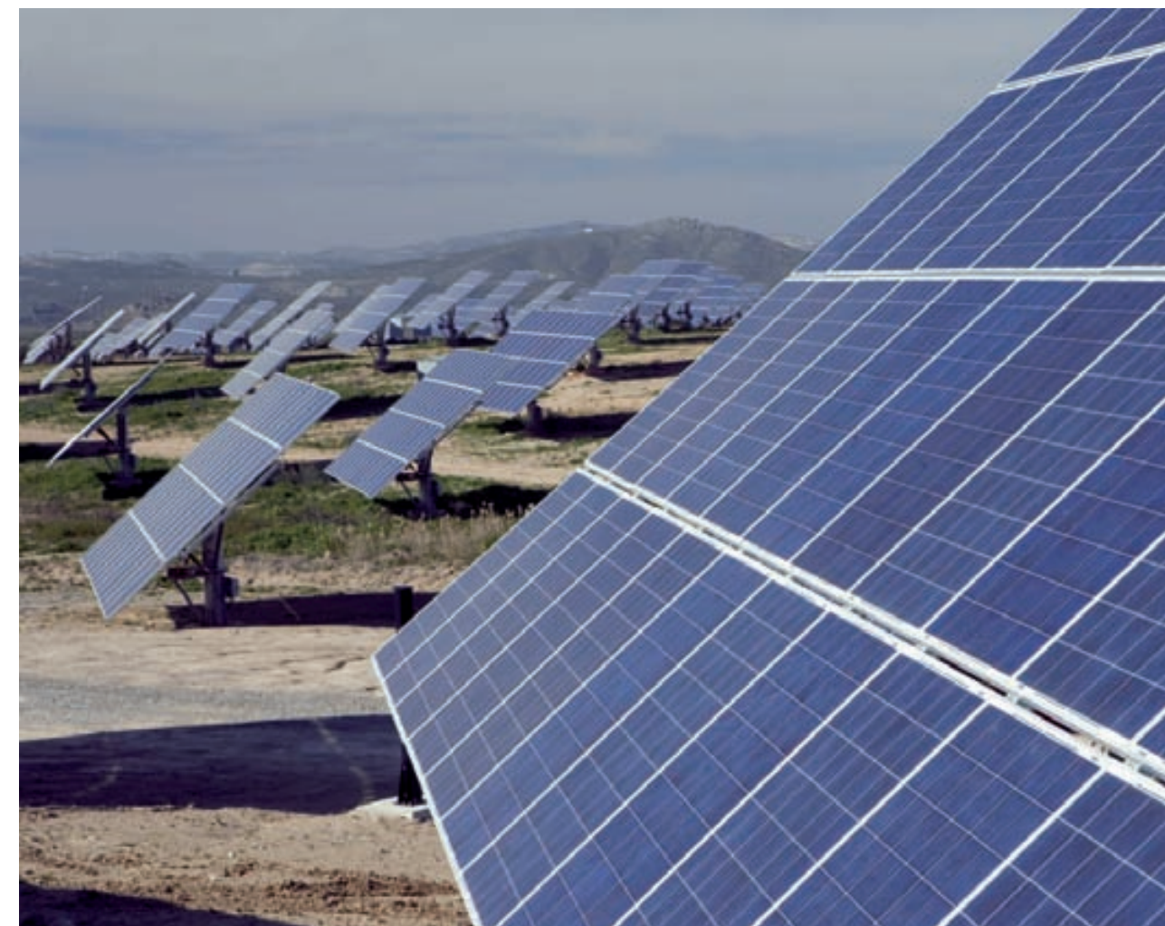
Énergie solaire photovoltaïque
