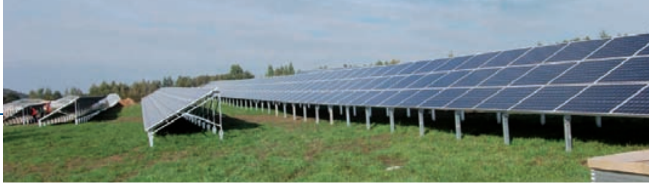
Centrale Photovoltaïque, Straz (République Tchèque)
