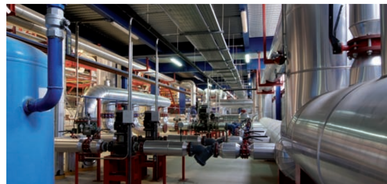
Fournisseur d'énergie du premier Accélérateur de Particules d'Espagne et du sudouest de l'Europe: Synchrotron Alba. Centrale de Polygénération de froid et chaleur à Cerdanyola del Vallés, Barcelone
