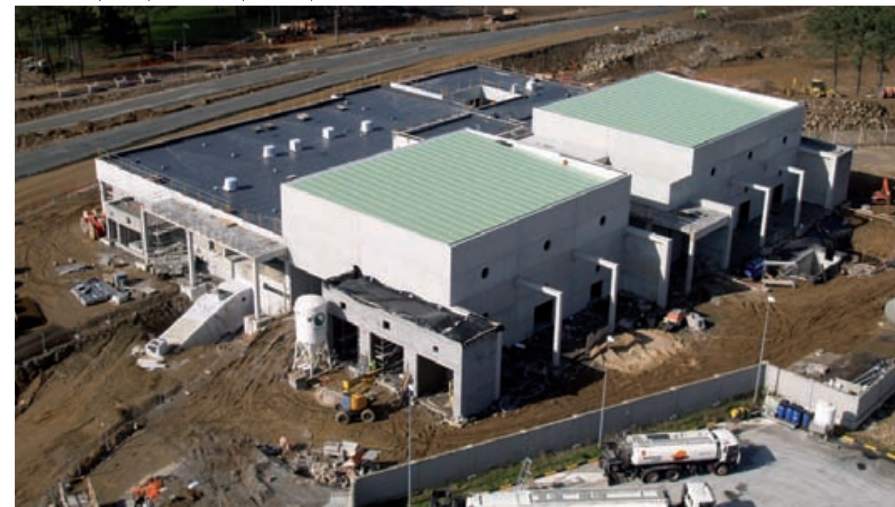
Centrale Electrique, Aéroport de Saint-Jacques-de-Compostelle
