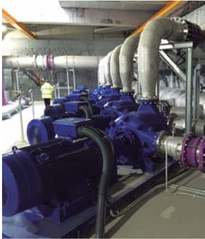
■ Approvisionnement d'eau de Arroyo Culebro, Madrid
