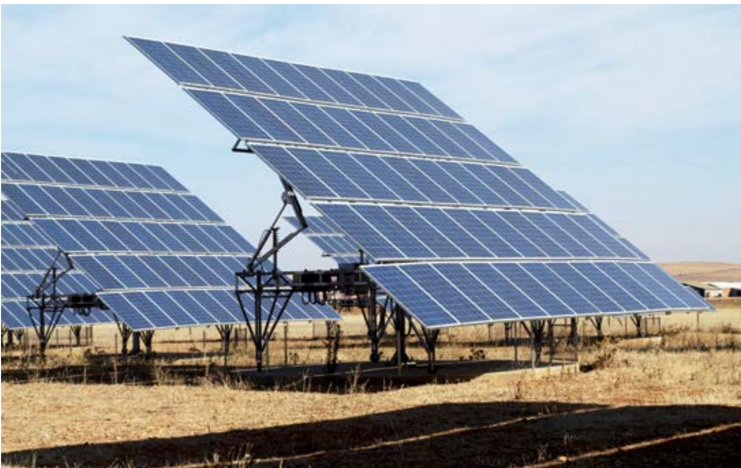
■ Parc solaire photovoltaïque de 3,33 MW à Toro, Zamora
