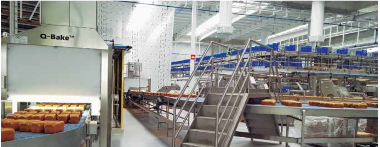
Installations mécaniques et climatisation de l'usine du Groupe Bimbo à Azuqueca de Henares, Guadalajara
