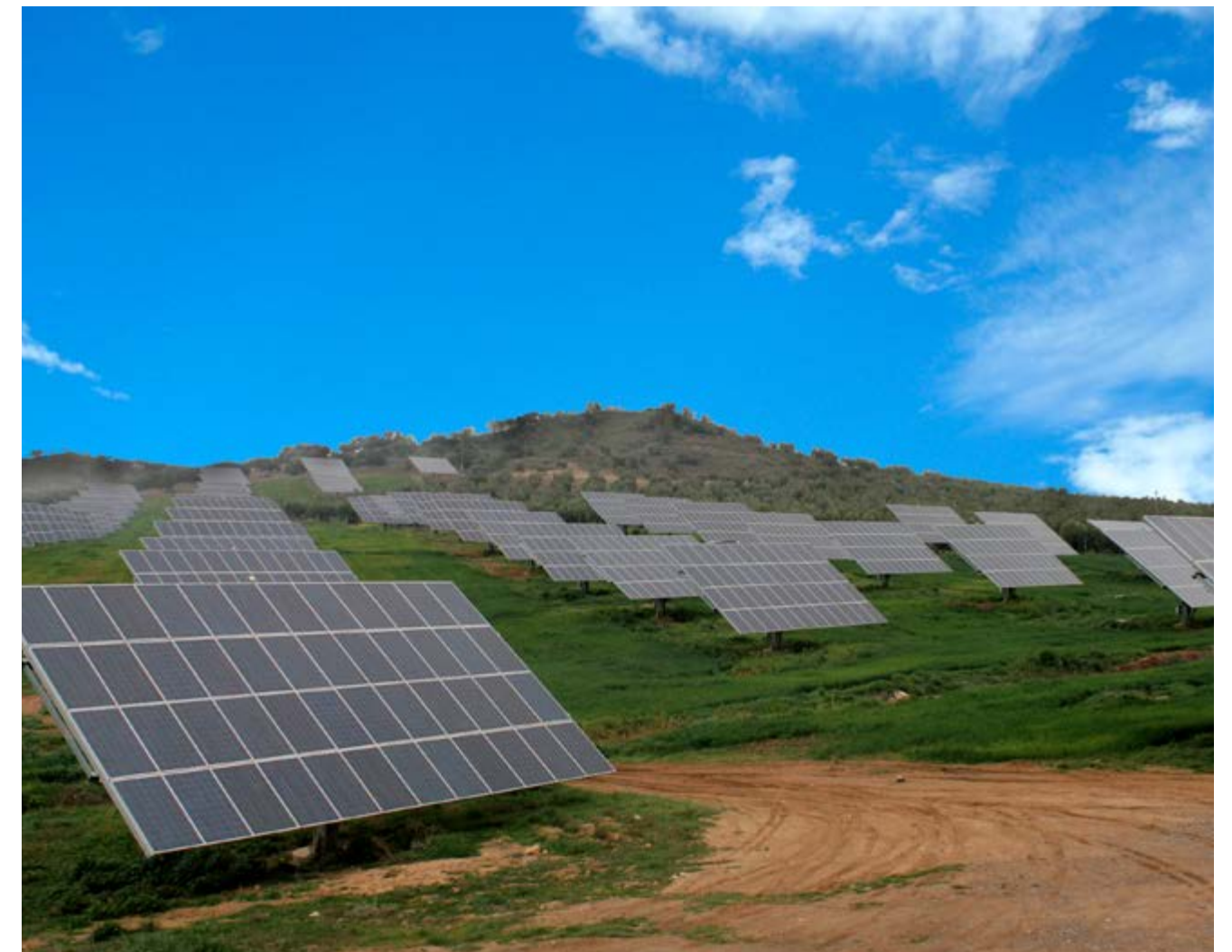
Centrale photovoltaïque à Alcaudete, Jaén (5,4 MW). Ingénierie et projet. GSJ Solutions / Construction SANJOSE Constructora
